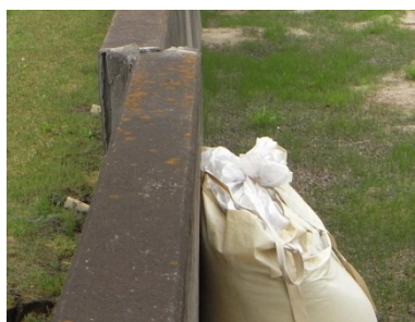
目地部の損傷例
