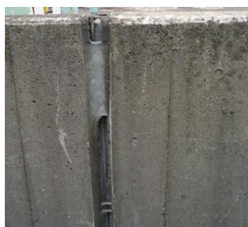
目地部の損傷例
