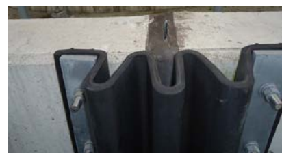
目地部の損傷例
