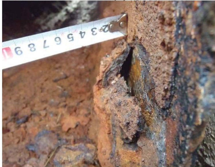
写真3-4-2 配管内面凸状部分(2) (一部をはつりとった状態)
