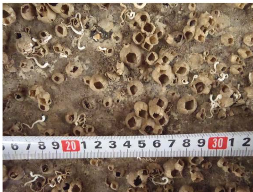
写真4-8 配管内面の状況(2)
