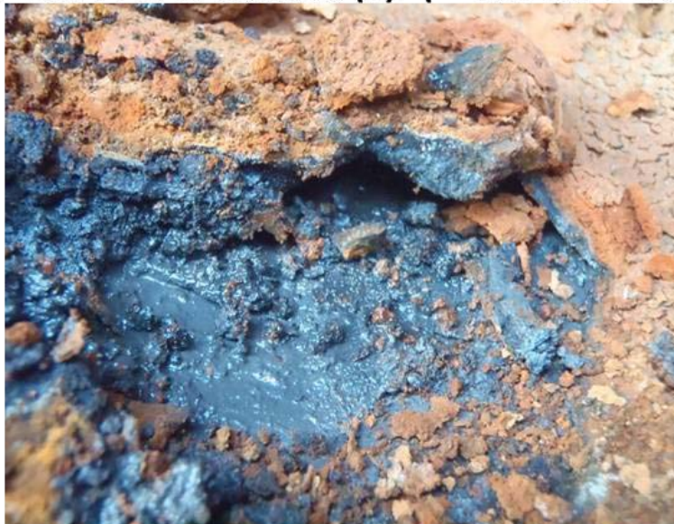
写真3-5-2 配管内面凸状部分(2) (一部をはつりとった状態)
