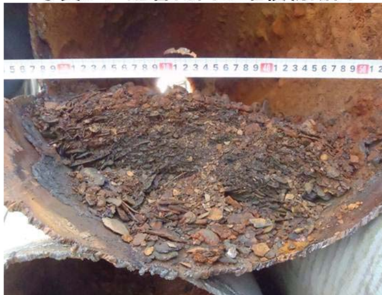
写真1-4 配管内面の堆積物断面
