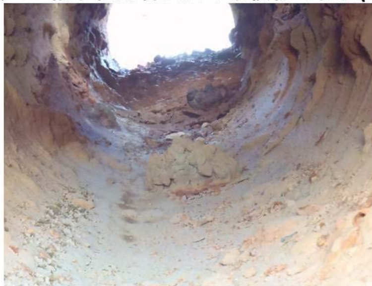
写真1-2 給水栓配管内面の堆積物の状況(2)
