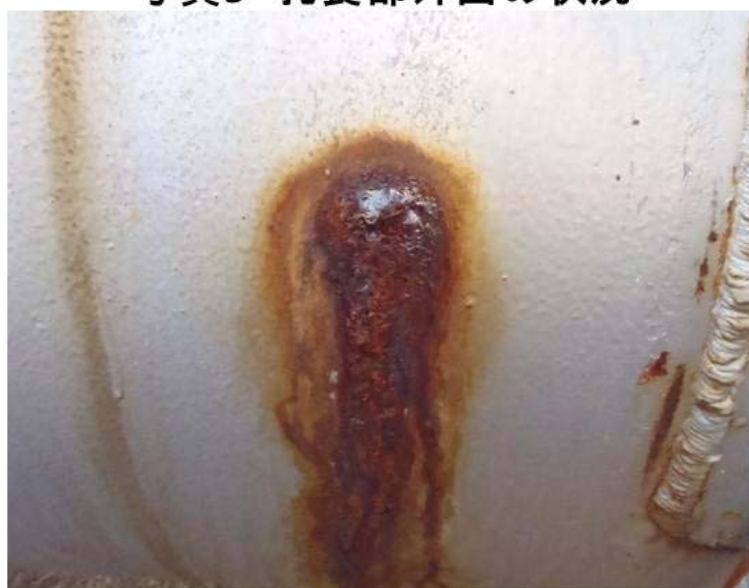
写真5 孔食部外面の状況
