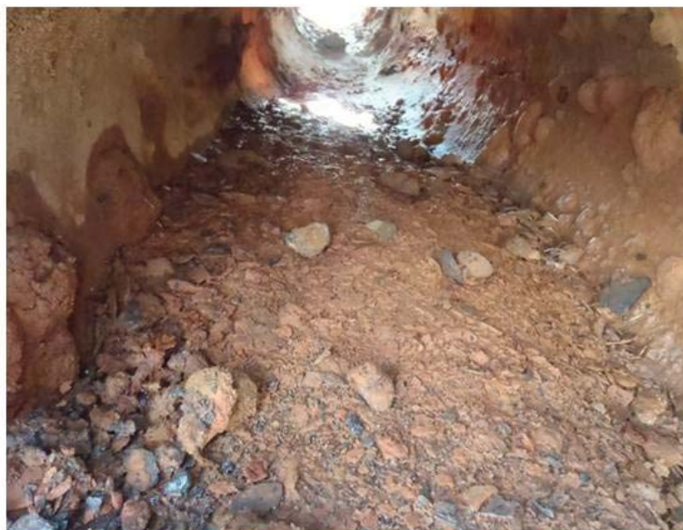
写真1-1 給水栓配管内面の堆積物の状況(1)
