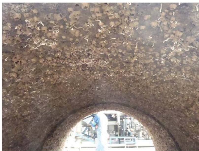
写真4-7 配管内面の状況(1)
