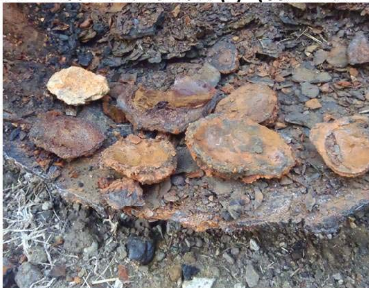
写真3-6-1 配管内面凸状部分(1) (剥がし取った裏面)
