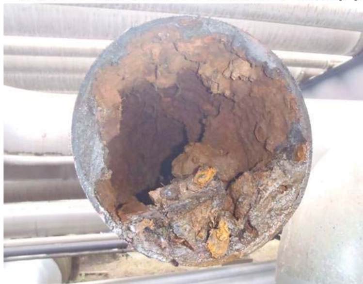
写真4-1 配管内面の堆積物の状況(1)
