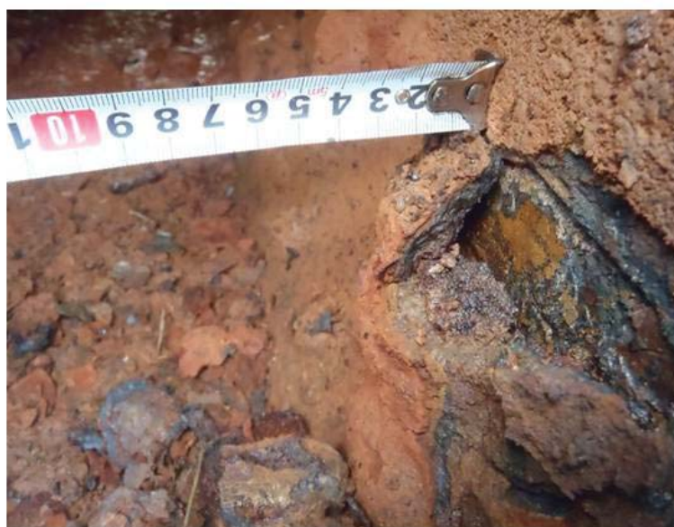
写真3-4-1 配管内面凸状部分(1) (一部をはつりとった状態)
