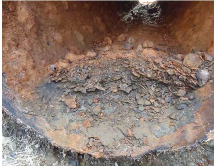
写真1-3 給水栓配管内堆積物(1)
