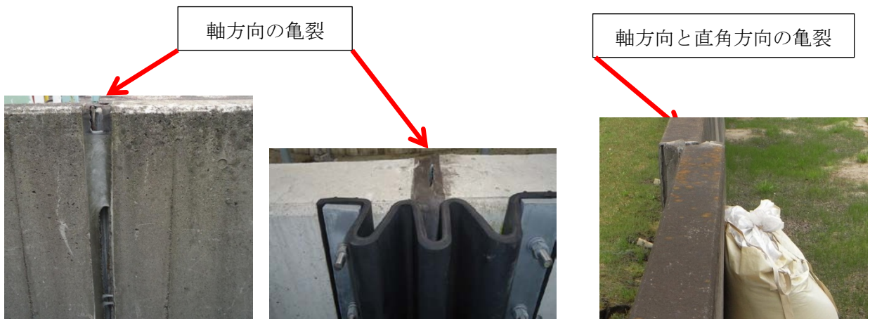
目地部の損傷例
