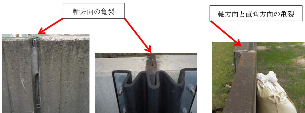
目地部の損傷例
