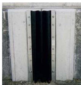
ゴム製可とう性材の設置例
