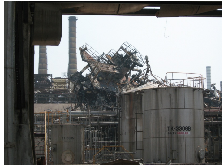
レゾルシン製造装置(西側から)
