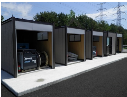
写真 2-5 高台に設けた非常用資材庫
