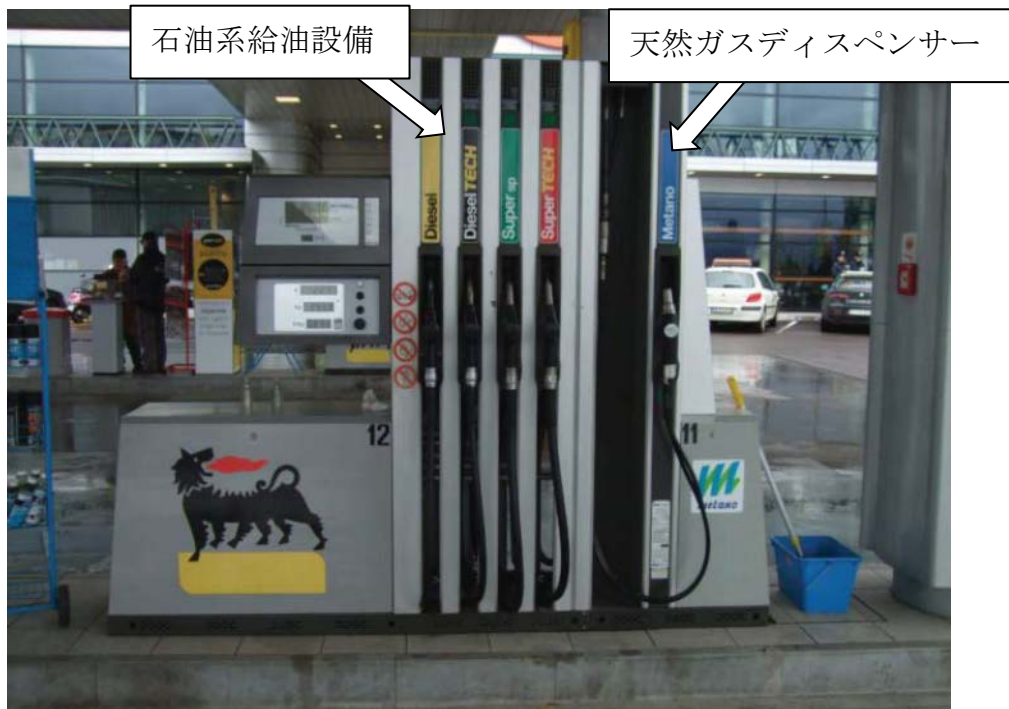
石油系燃料の給油設備と天然ガスのディスペンサーが一体となったマルチディスペンサー（ドイツ）（引用：日本ガス協会資料）
