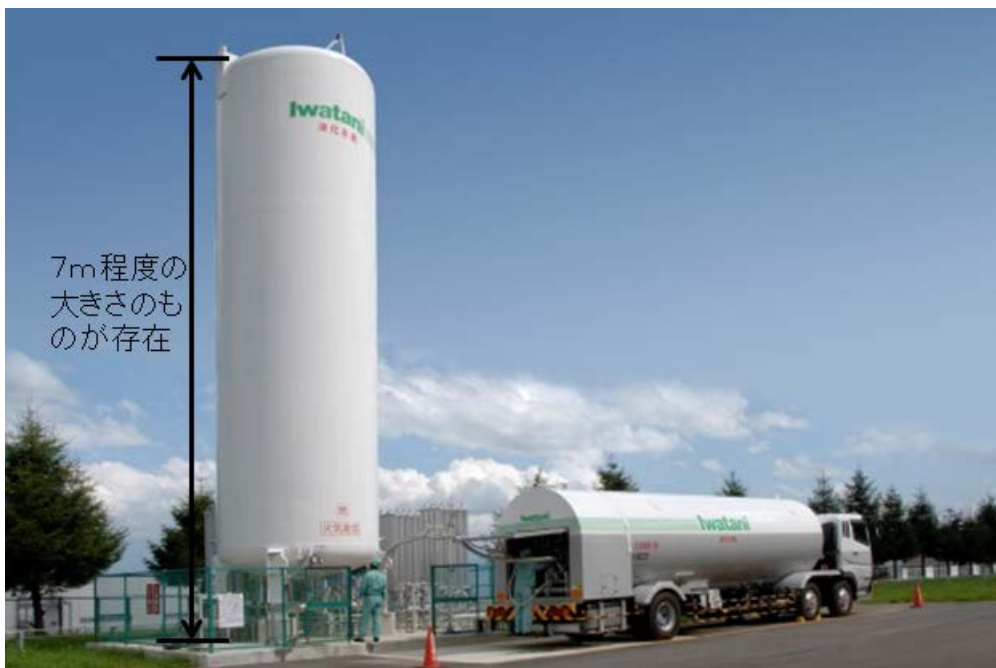
図 3.3 液化水素貯槽の例
