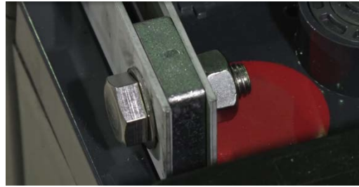
端子接続部（緩めた状態）
