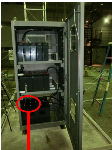
実験用キュービクル式蓄電池設備
