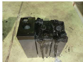
放電状態電池
