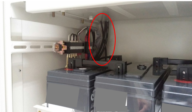
ケーブル設置例
