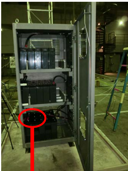
実験用キュービクル式蓄電池設備
