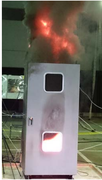
鉛蓄電池延焼状況⑤
