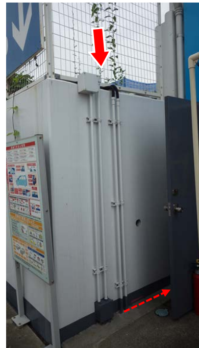
写真14 太陽電池モジュールの電気配線③ 防火塀裏側→金属管→地下 →倉庫内のパワーコンディショナー
