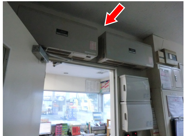
写真 29 販売室に設置されたパワーコンディショナー（2基）
