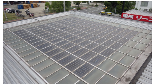
写真 22 キャンピー全体を上から撮影 電気配線の露出はない。
