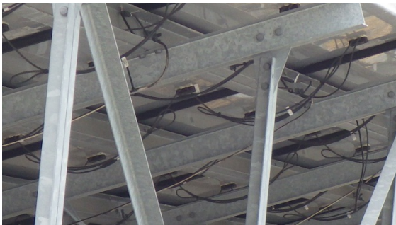
写真10 太陽電池モジュール裏面の電気配線
