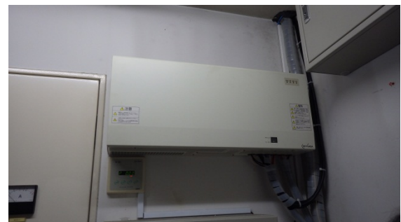
写真15 パワーコンディショナー
