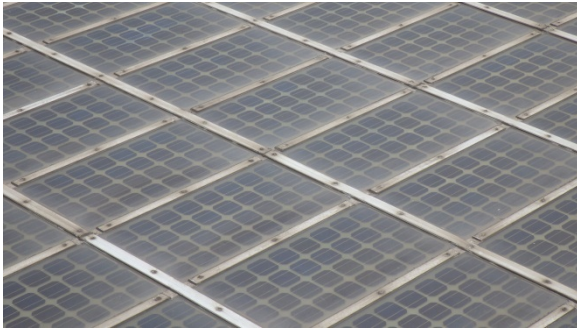
写真 24 太陽電池モジュール
