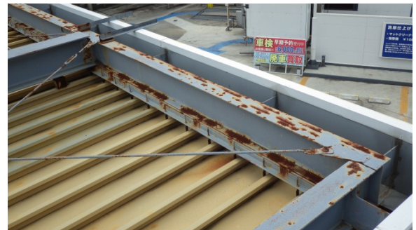
写真 6 キャノピーの梁の腐食状況
