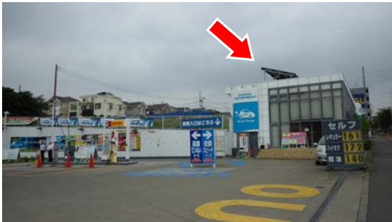
写真 2 倉庫 (旧販売室) の屋根にも太陽電池モジュールが設置されている。
