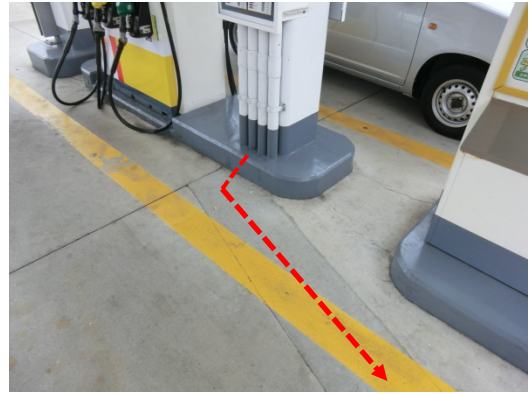
写真13 太陽電池モジュールの電気配線② 写真12の金属管→防火塀裏側（給油取扱所敷地外）→写真14 矢印部分
