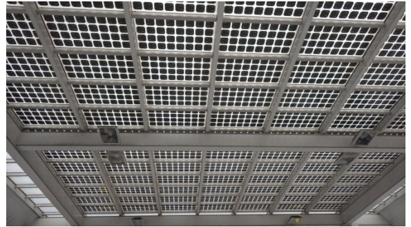
写真 28 太陽電池モジュールを下方から撮影
