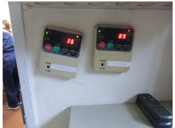
写真 31 発電量モニター
