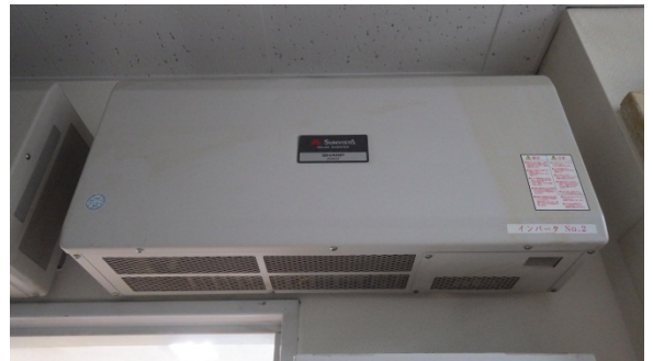
写真 30 パワーコンディショナー
