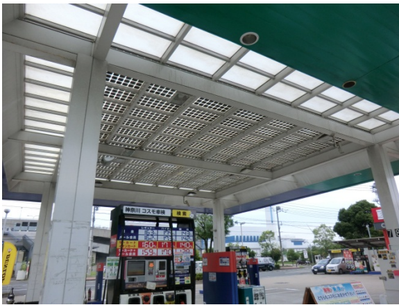
写真 18 キャンピー中央に設置された透過型の太陽電池モジュール
