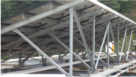
写真9 太陽電池モジュールの架台
