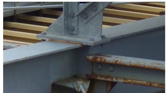
写真 7 架台と梁の固定状況及び腐食状況
