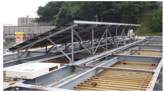
写真 5 キャノピー上の太陽電池モジュール
