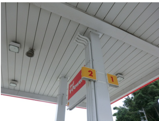
写真12 太陽電池モジュールの電気配線① 写真11の接続箱→柱に設置された金属管→地下（写真13点線部分へ）
