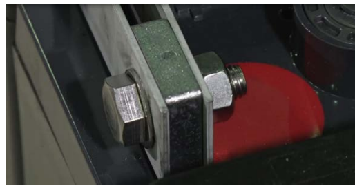
端子接続部（緩めた状態）
