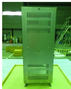
【キュービクル背面の給排気口】
