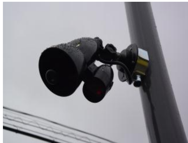
写真16 人感センサー(音声通知有り) (給油取扱所に設置)
