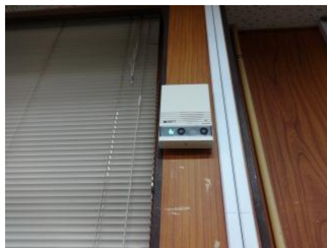
写真18 センサー発報部(店舗等に設置)
