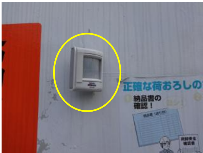
写真15 人感センサー(給油取扱所に設置)
