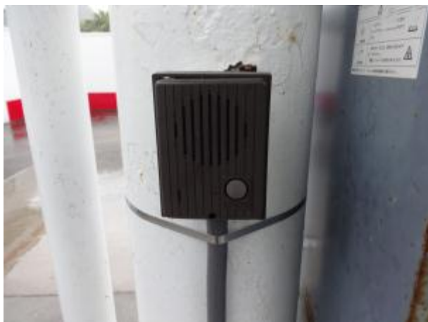
写真11 インターフォン(給油取扱所に設置)
