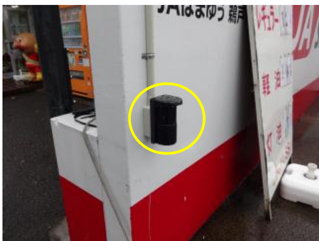
写真17 車両検知センサー(給油取扱所に設置)
