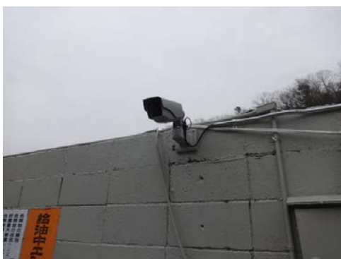
監視カメラ（給油所奥側）
