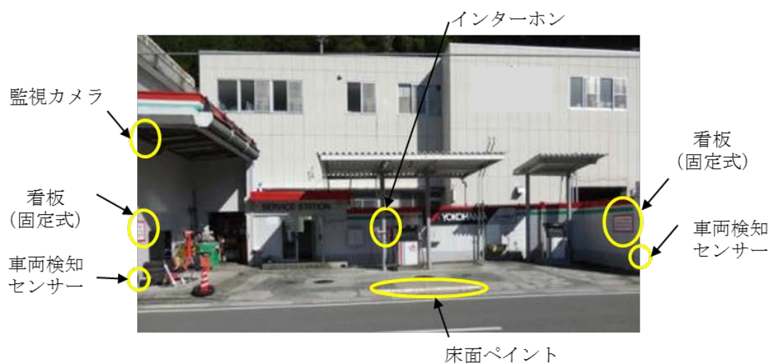
図9 機器等の設置場所
