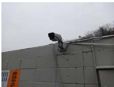
監視カメラ（給油所奥側）
