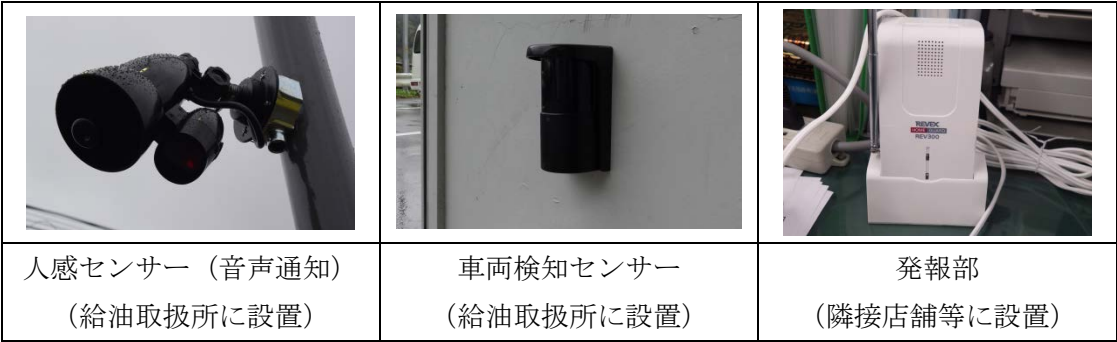
図 19 センサーの設置状況
