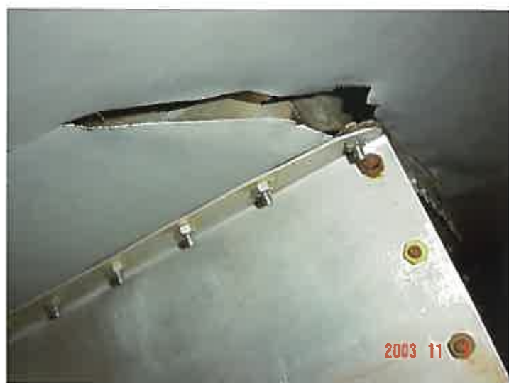
デッキの損壊状況
