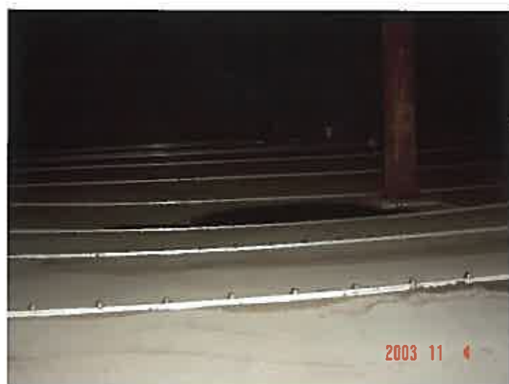
デッキ上への滞油
