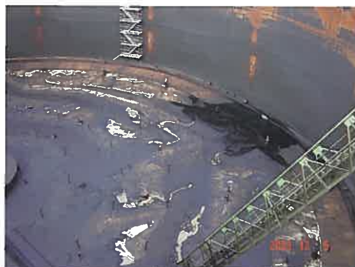
デッキ上への滞油
