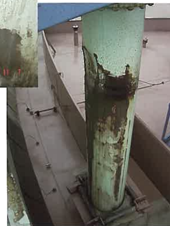
回転止めの損傷状況
