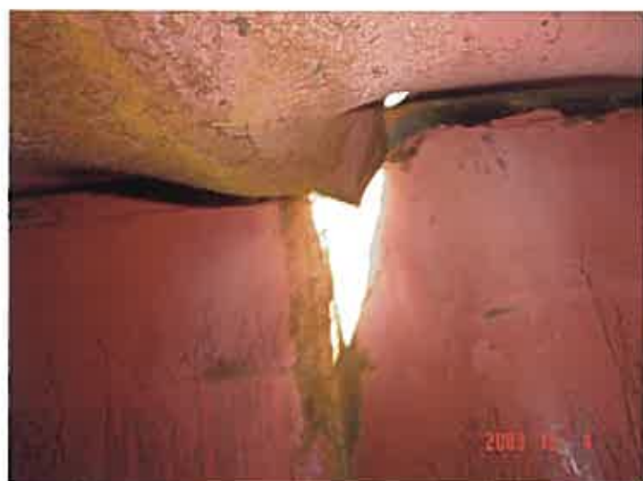
挫屈によるアウターリムとアッパーデッキとの隙間（内側）
