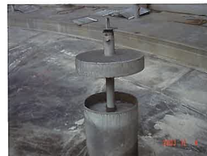
持ち上がったままとなった自動空気抜き（50cm上昇）
