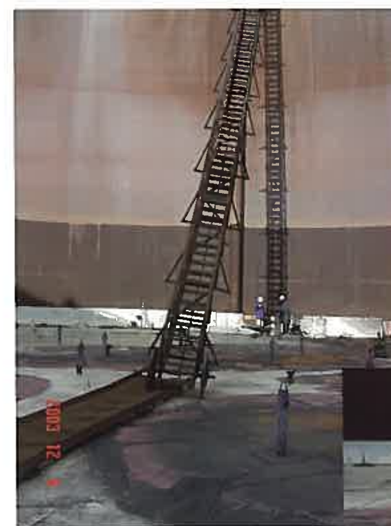
ローリングラダーの損傷状況
