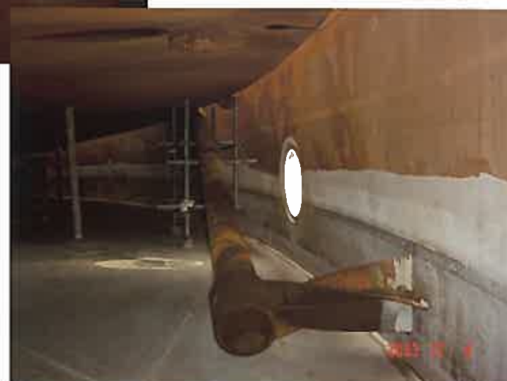
浮屋根により変形した ゲージポール下部
