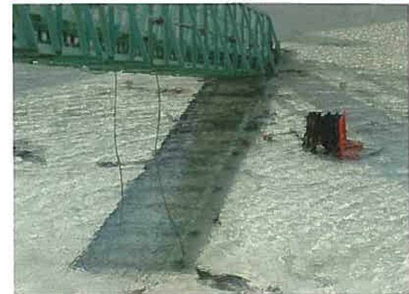
9/26 15:30 浮き屋根上へのナフサの漏洩状況【出光興産(株)提供】
