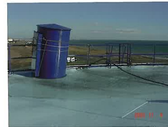
屋根上の撓み状況（検尺小屋は傾き、屋根板の凹部に雨水が帯水）
