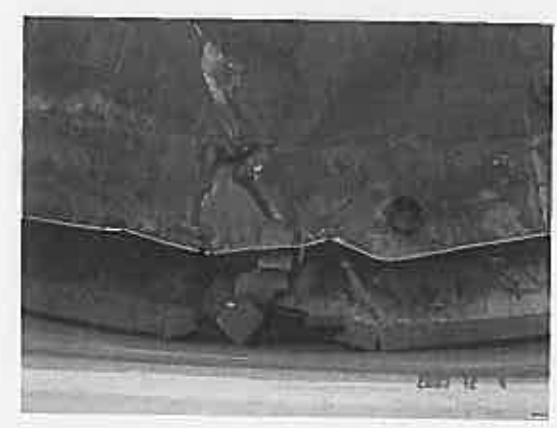
ウェザーシール破損
