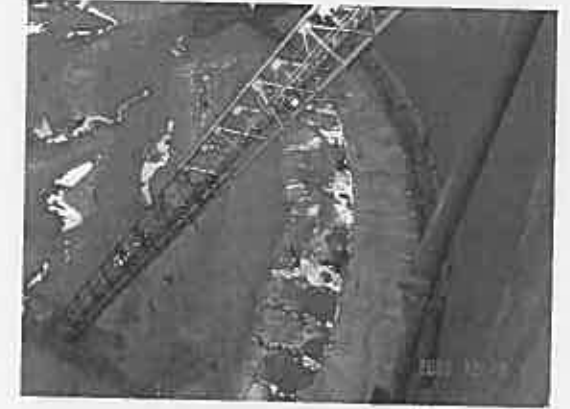
ゲージホール上部から約 8m 付近で 「く」の字に変形
