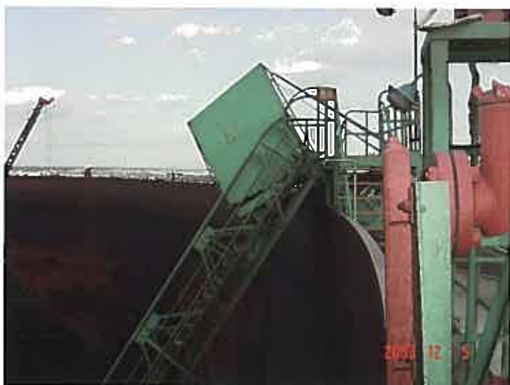
損壊した測定小屋（タンク内側へ30°傾斜）、固定ボルトも破断
