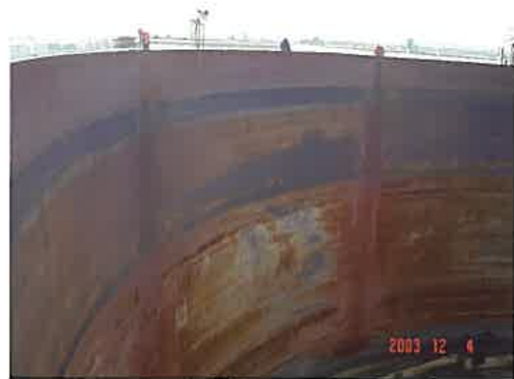
スロッシング痕の状況
