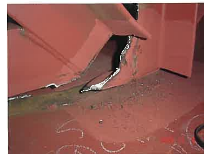
センターポンツーン内の支柱破断
