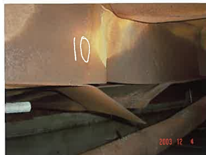
損傷したポンツーンローアーデッキ
