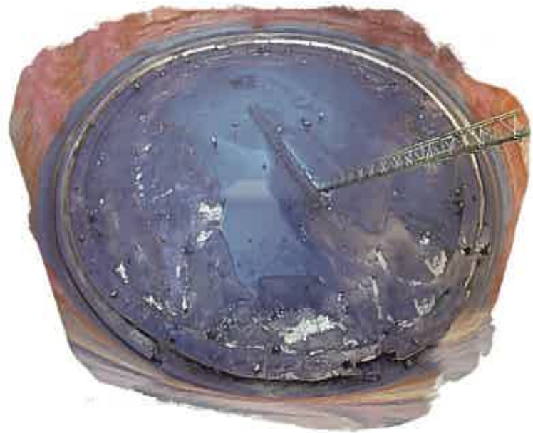
沈没した浮屋根の状況（全体）
