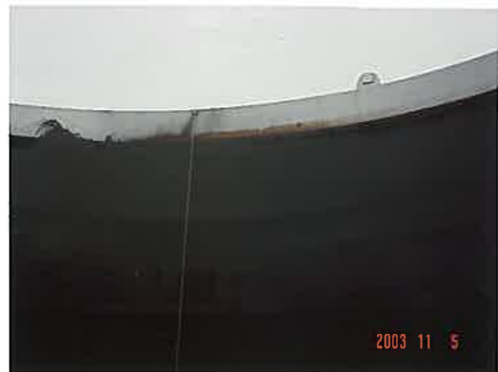
スロッシング痕の状況（浮屋根上への溢油）
