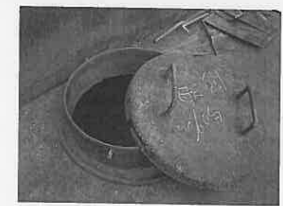
ポンツーンマンホール蓋の外れ
