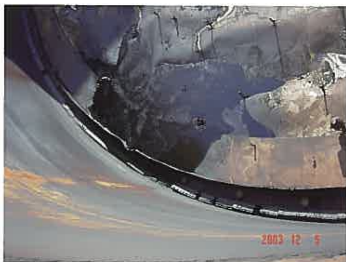
デッキ上への滞油
