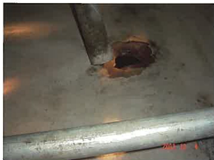
デッキポストが貫通した底板
