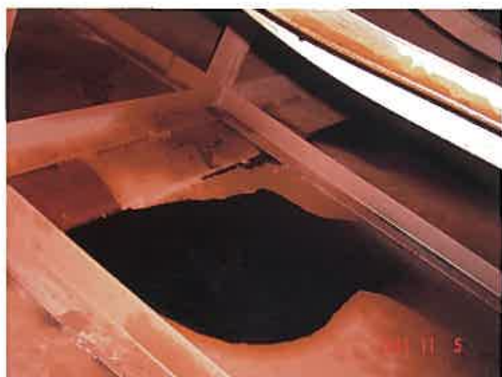
ポンツーン内への油の浸入
