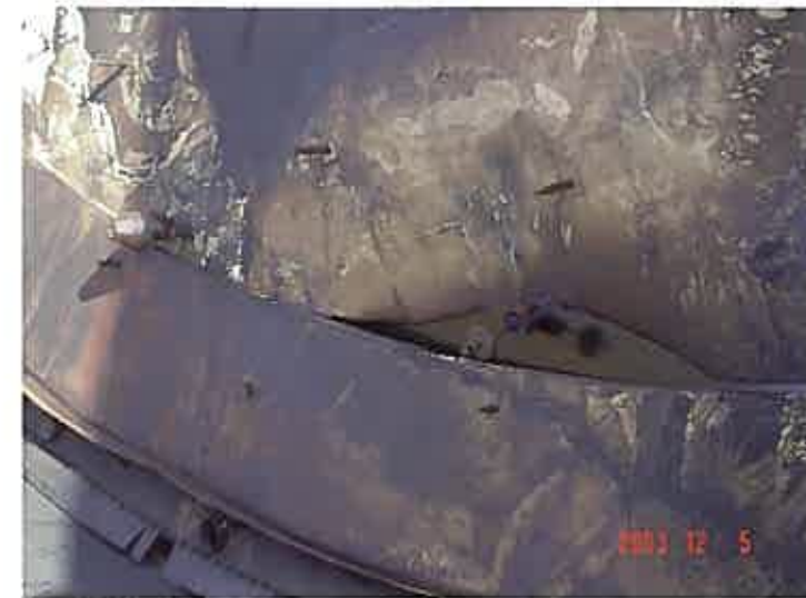
ポンツーンとデッキ接合部の破断
