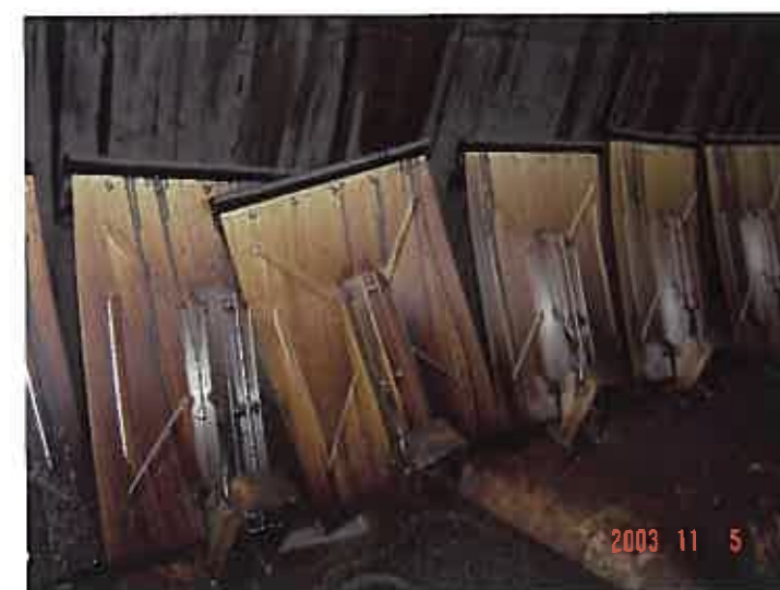
破損したウェザーシール
