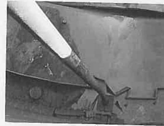
8B 回転止め中央部付近へ約 1 mm 変形
