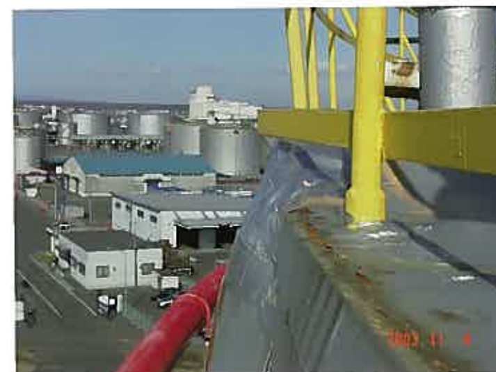
固定屋根頂部の変形状況
