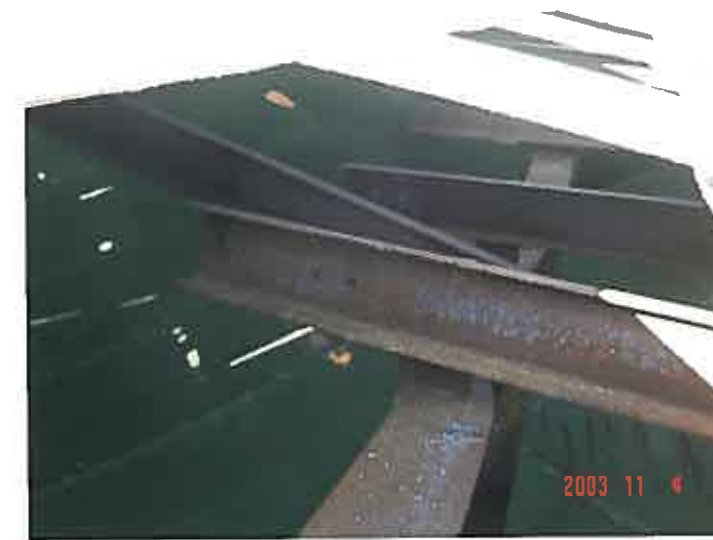
屋根骨の変形状況
