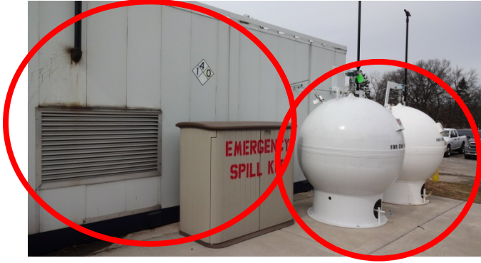
圧縮機と CNG タンク
