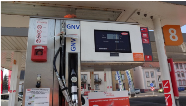
CNG ディスペンサー 緊急停止スイッチと緊急離脱カブラ
