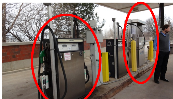
手前が固定給油設備、奥が CNG ディスペンサー
