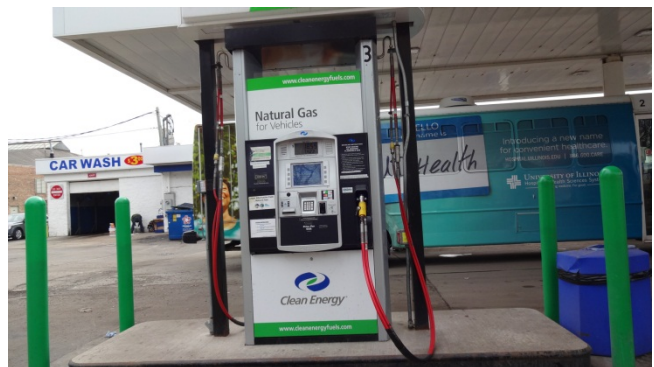
CNG ディスペンサーとガードポール
