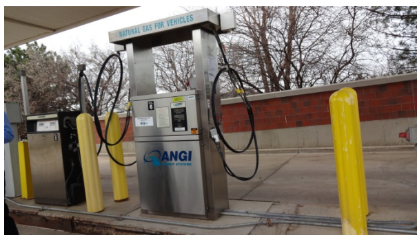
CNG ディスペンサーとガードポール
