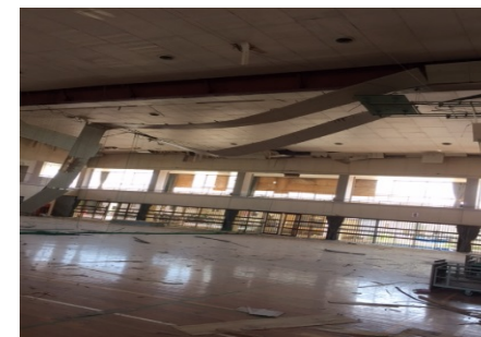
天井の一部が落下した体育館
