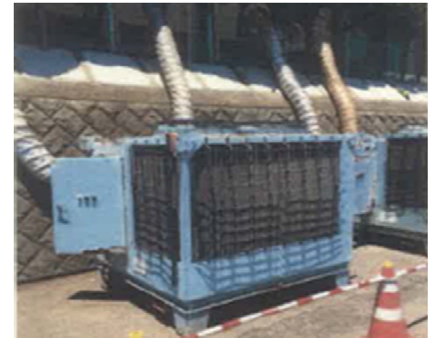
エアコン(室外機)
