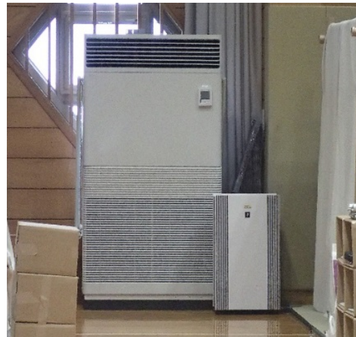
エアコン(室内機)
