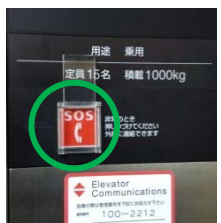
非常電話の例 (エレベータ内)
