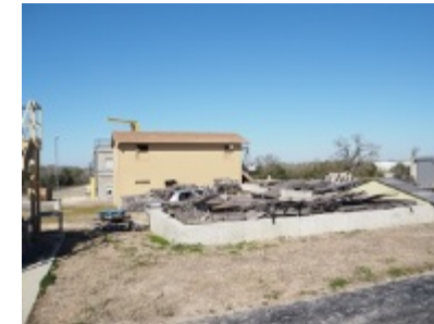
136ビル崩壊がれき
