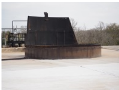
47タンク、防油堤火災
