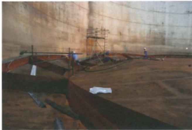
写真 10-5-1 浮き蓋の破損状況
