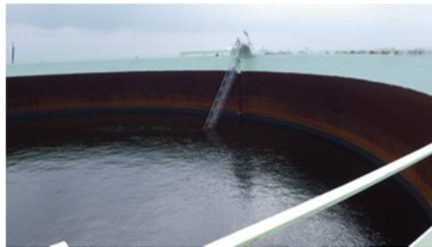
写真 10-4-2 浮き屋根が完全に沈んだ状態
