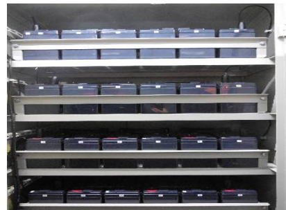
図6-3-4 非常電源設備（蓄電池）の例
