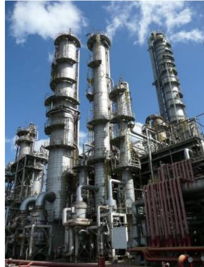
写真 2－3－2 高圧ガス設備（蒸留塔）
