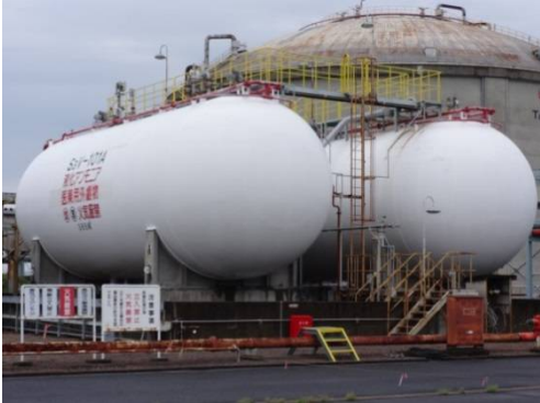
写真 2－3－1 高圧ガス設備（槽）
