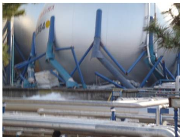
写真 10-2-1 364 番タンク 15 時 20 分頃の状況
