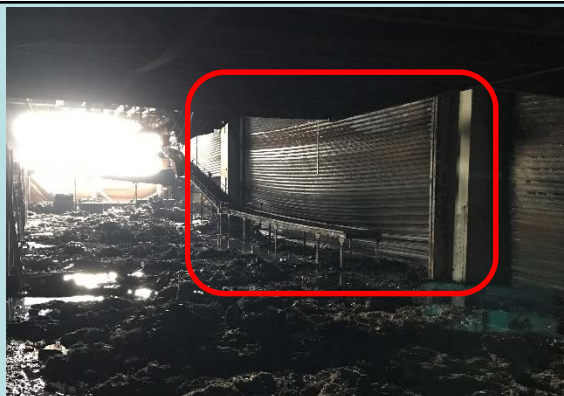
＜2Fの防火シャッター＞
