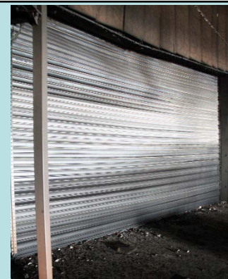
＜3Fの防火シャッター＞
