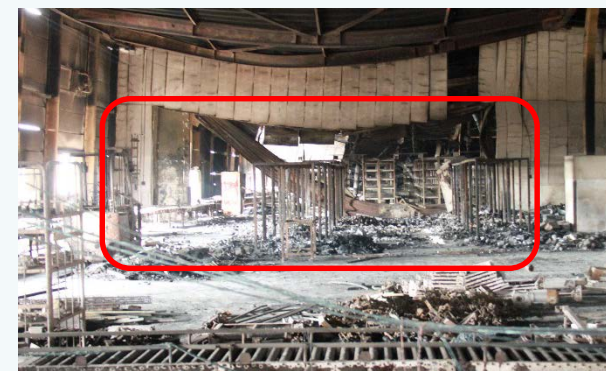
＜3Fの防火シャッター（作動せず崩落）＞
