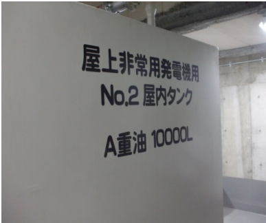
非常用電源設備用の危険物タンクの例 (屋内タンク貯蔵所)
