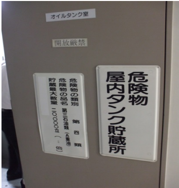
非常用電源設備用の危険物タンクの例 (屋内タンク貯蔵所)
