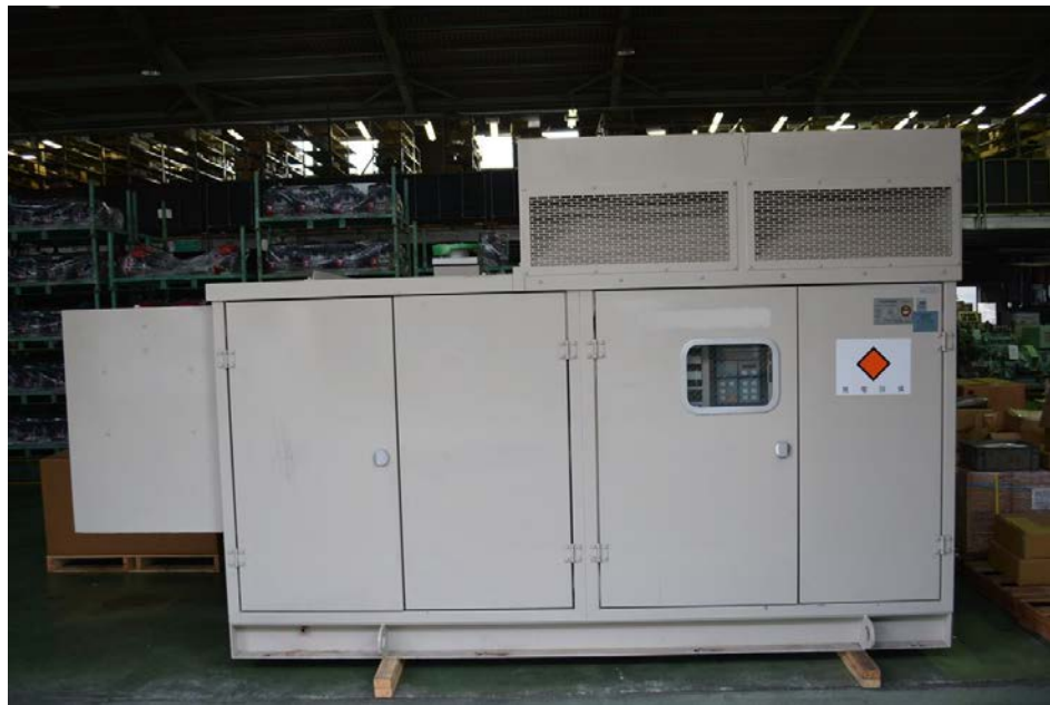
キュービクル式自家発電設備の例
