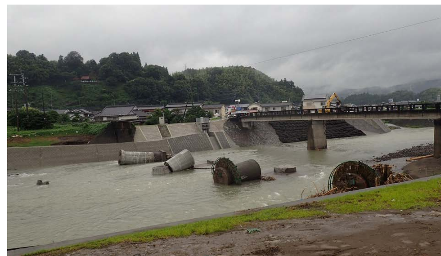
JR九大線 橋梁流失(大分県日田市)
