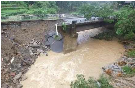
国道211号線 道路橋被災 (7/14 仮復旧済)
