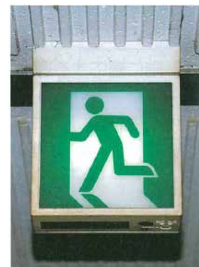
避難口誘導灯
