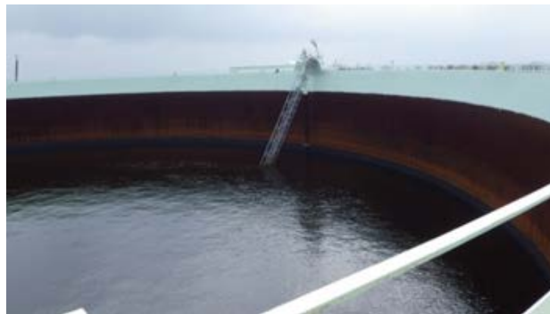
写真 10-4-2 浮き屋根が完全に沈んだ状態
