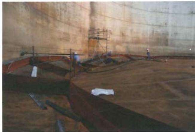
写真 10-5-1 浮き蓋の破損状況
