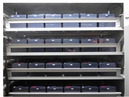
図6-3-4 非常電源設備（蓄電池）の例
