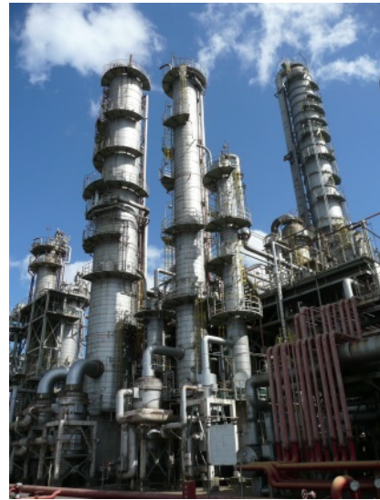
写真 2－3－2 高圧ガス設備（蒸留塔）
