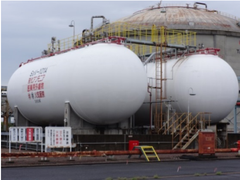
写真 2－3－1 高圧ガス設備（槽）
