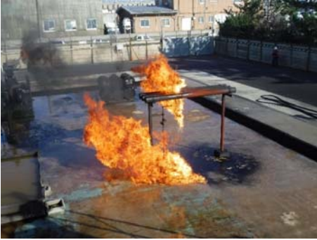
フランジから油が漏えいして出火
