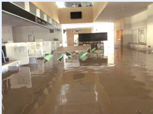
浸水した庁舎1階
