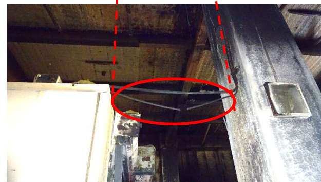
煙感知器の伝送線が収納された保護管(鋼管)の破断状況
