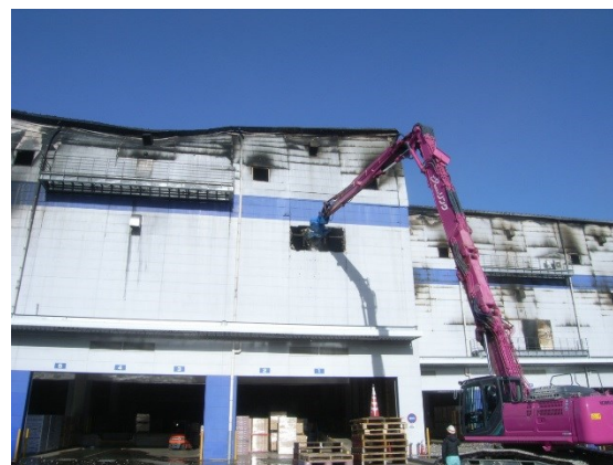
西面破壊状況
