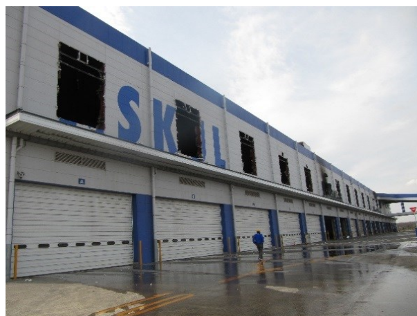
東面破壊状況
