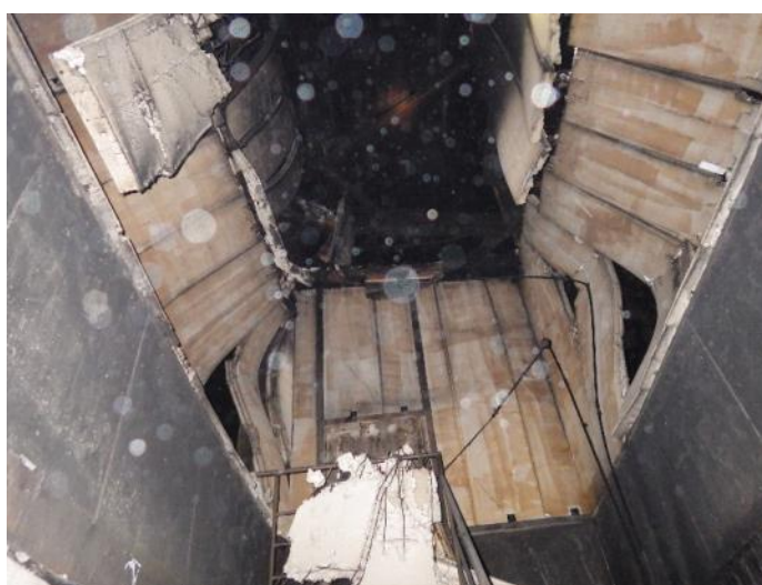
写真 1-2-9 階段室内 ALC パネル損傷状況
