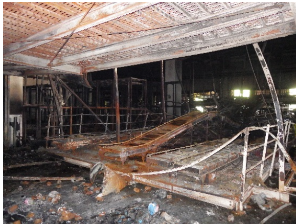
写真 1-2-8 吊り下げベルトコンベヤ落下状態
