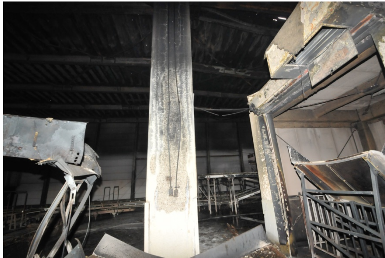
写真 1-2-5 端材室上部開口部（2階部分）付近の爆裂している柱
