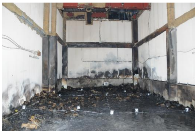
写真 1-2-1 端材室南側内部の状態（写真右上の黒い箇所が開口部）
