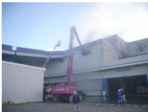
写真 3-1-8 開口部破壊状況 (17 日 17 時 13 分頃)
