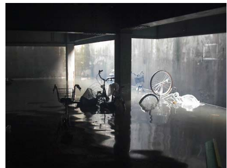
写真 5-13 地下浸水（地下駐輪場）
