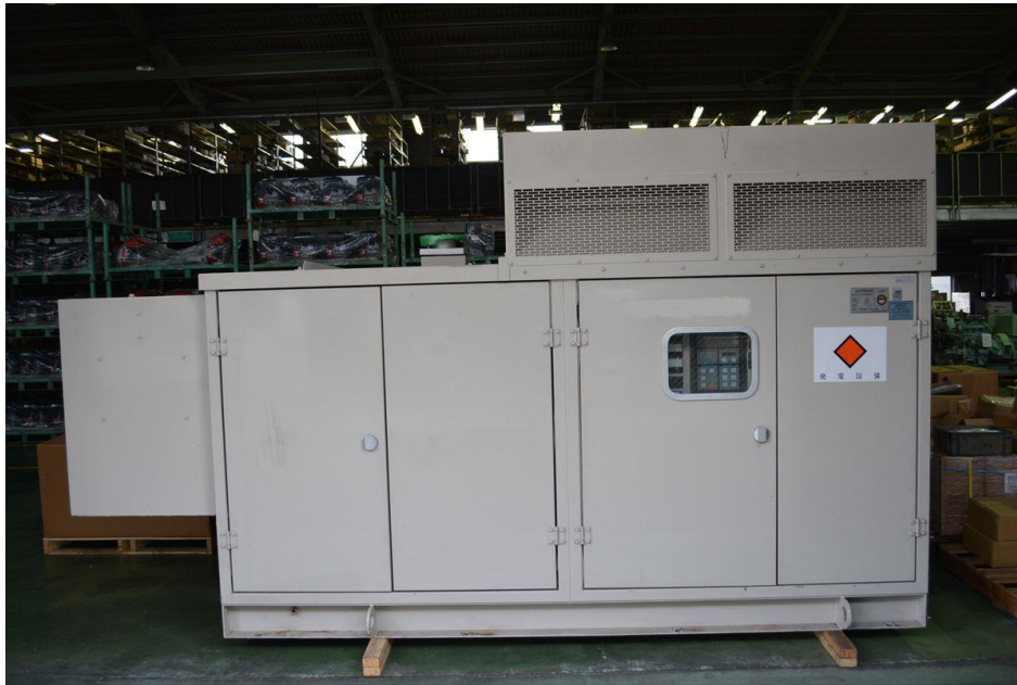
キュービクル式自家発電設備の例
