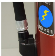
× 消火薬剤の漏れ
