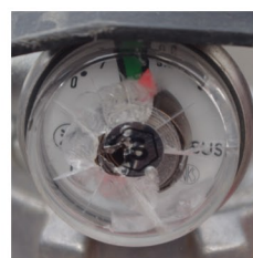
× 指示圧力計の損傷
