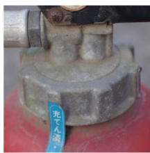
× キャップの劣化
