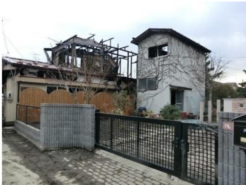
写真D 建物火災の状況
