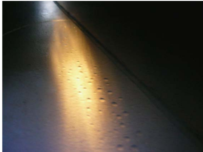
図2 屋外貯蔵タンク内面コーティングの膨れの発生状況
