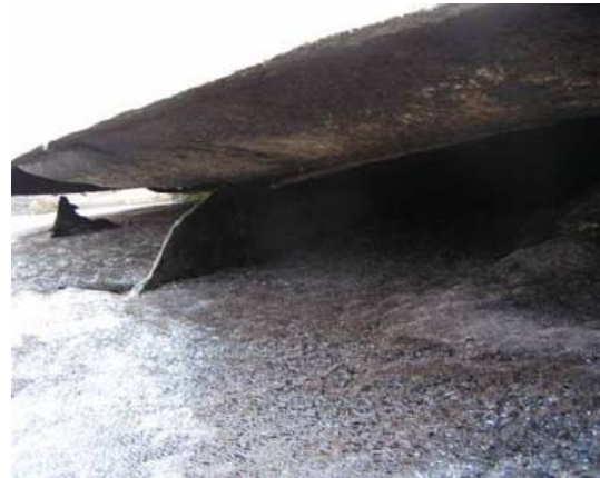
写真：その後底板が破断した状況
