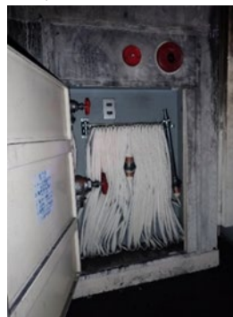
図 13 屋内消火栓内部
