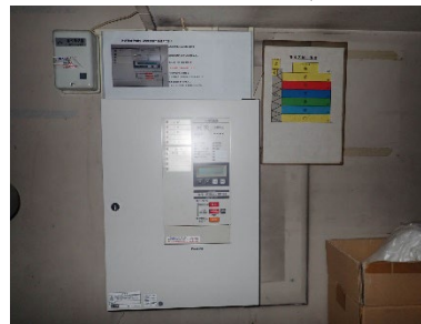
図 23 受信機設置状況
