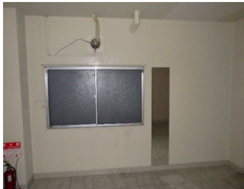
図8 4階診察室の直上同位置にある部屋（5階空きテナント）
