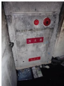
図 12 屋内消火栓設置状況
