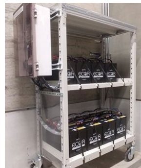
鉛蓄電池（密閉型） (8.2kW)
