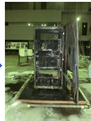
蓄電池燃焼後
