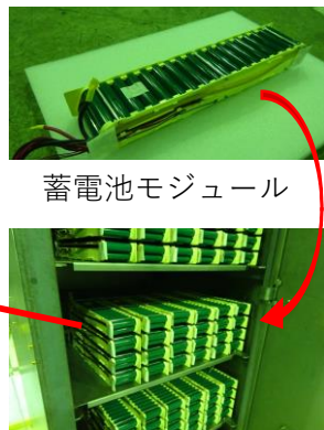
蓄電池配置状況
