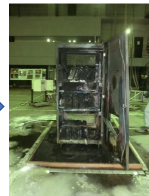
蓄電池燃焼後
