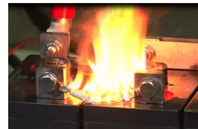
電線発火状況
