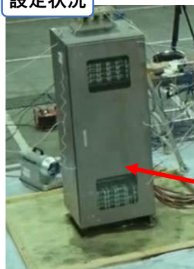
実験用蓄電池設備
