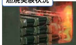
蓄電池発火時
