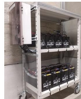
鉛蓄電池（密閉型） (8.2kWh)
