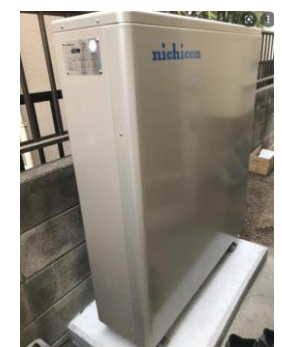
リチウムイオン蓄電池 (16.6kWh)
