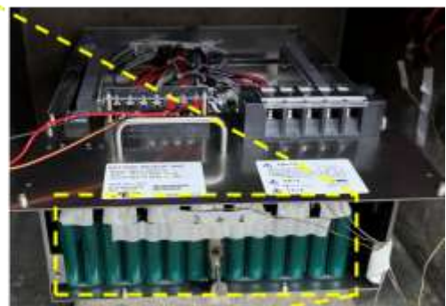
図 18：蓄電システム外観
