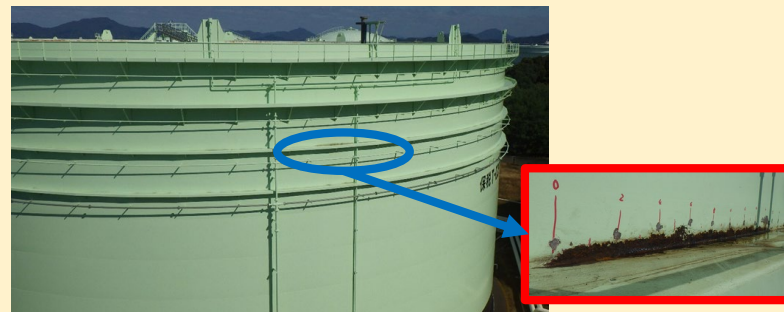
写真2－側板腐食部から漏えいしたタンク
