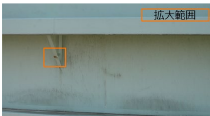
図 3-18 検証に用いた腐食
