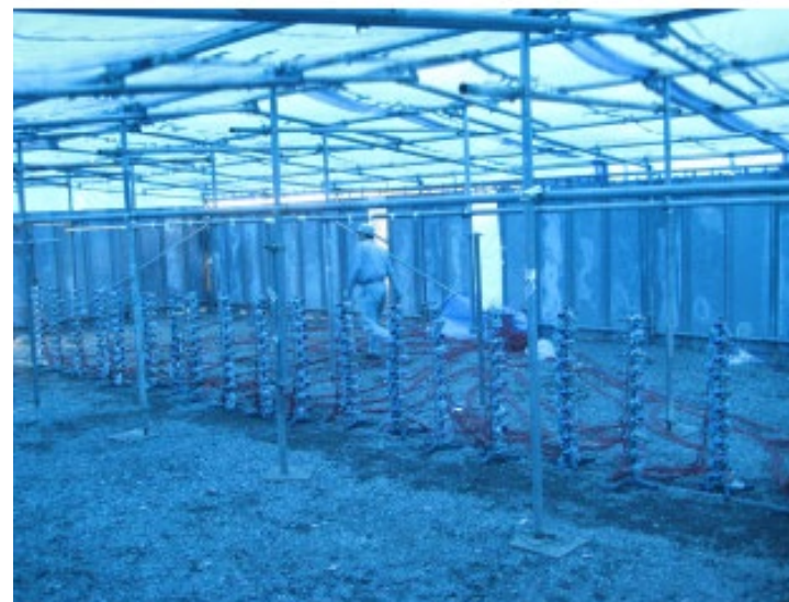
センサー設置状況
