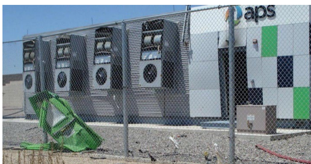
写真 2-2 米国アリゾナ州でのリチウムイオン蓄電池設備の火災
