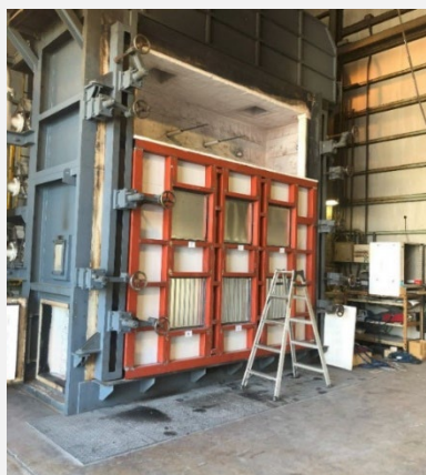
加熱炉の全景
