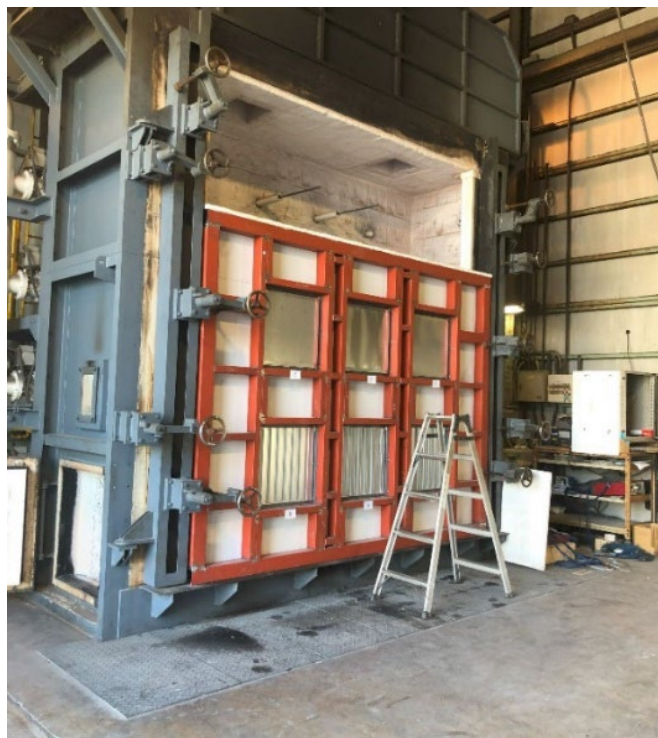
加熱炉の全景
