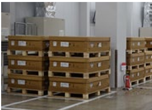
写真1 リチウムイオン蓄電池の集積の例
